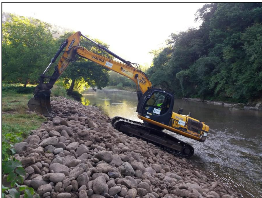
Maquinaria apilando acarreo en la zona donde previamente se ha realizado el rescate de anfibios
