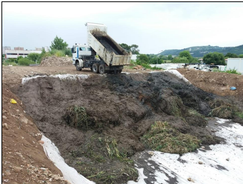
Depósito de lodos en vertedero autorizado sobre geotextil para facilitar la desecación
