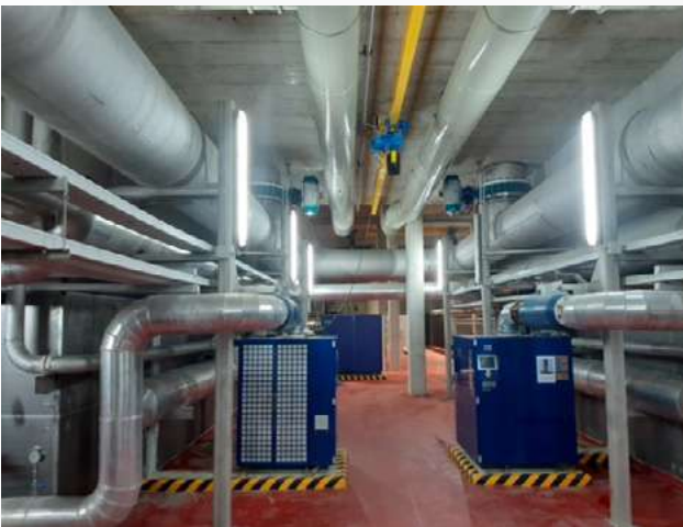
Foto: Galería de soplantes del tratamiento biológico.
