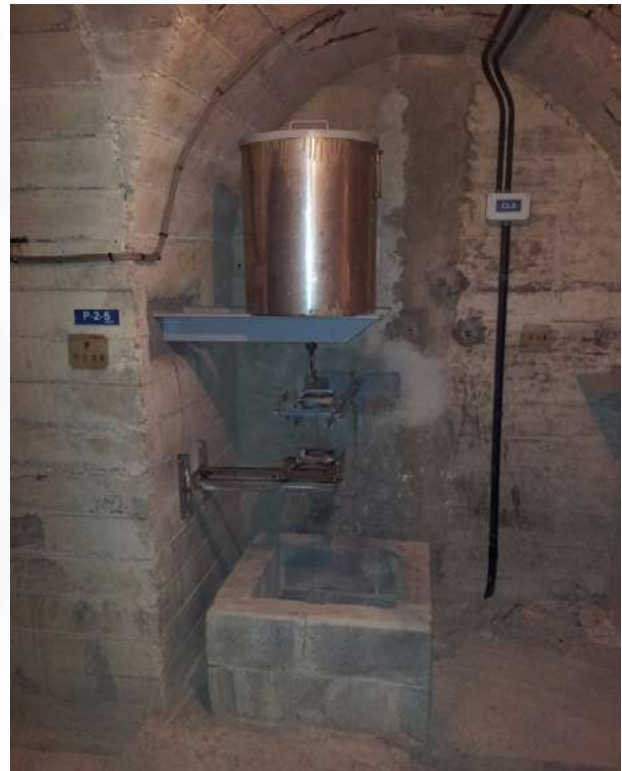
Foto: Elementos de auscultación de presas. Péndulo para medición de deformaciones en la presa de Tanes (Asturias). Fuente: Fondo documental del Organismo.
