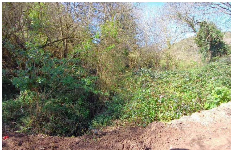
Antes de los trabajos: cauce tomado por la vegetación
