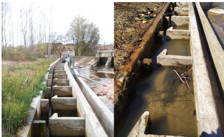
Figura 11. Escala de la C.H. de Vadocondes (río Duero). Izquierda: escala vaciada. Derecha: escala colmatada tras una gran avenida.
