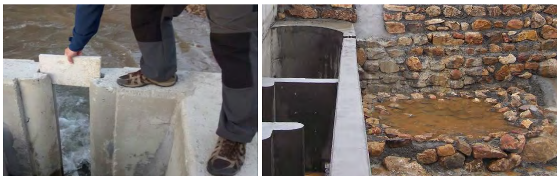
Figura 105. Izquierda: Umbral regulable en un vertedero de una escala de artesas (Río Arlanzón, Burgos). Derecha: Poza de disipación de energía en la salida de una escala de artesas, en el azud de La Flecha en el río Tormes (Salamanca).
